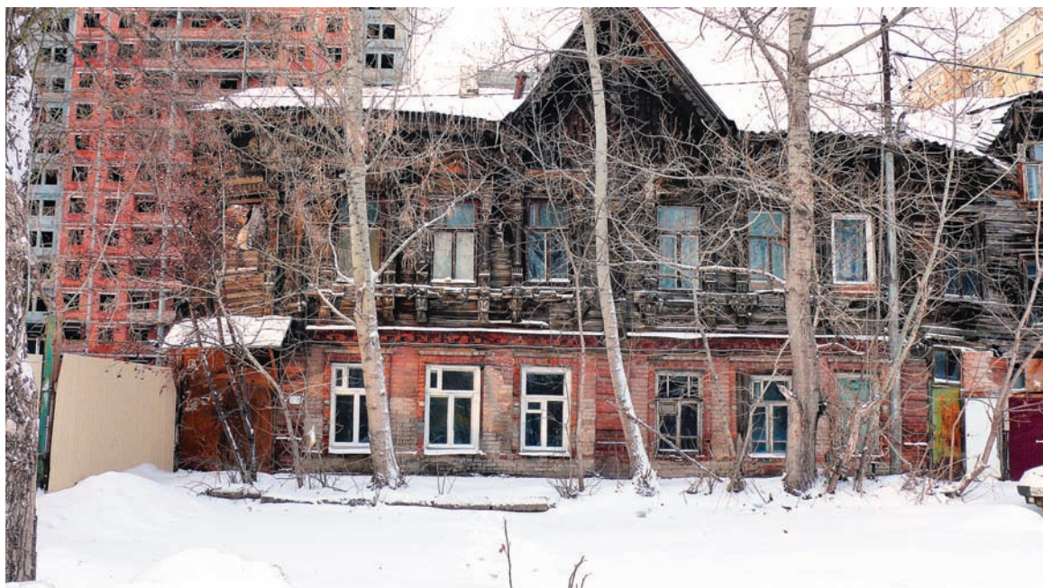
ВЫХОДНЫЕ И ПРАЗДНИКИ В САМАРЕ НЕ ПЕРВЫЙ РАЗ ИСПОЛЬЗУЮТ ДЛЯ НЕЗАМЕТНОГО СНОСА ПАМЯТНИКОВ АРХИТЕКТУРЫ. ТАК БЫЛО С БАНЕЙ КУПЦА ЛЕБЕДЕВА НА УЛИЦЕ АРЦЫБУШЕВСКОЙ, ТЕПЕРЬ — С ДОМОМ БЫКОВА
